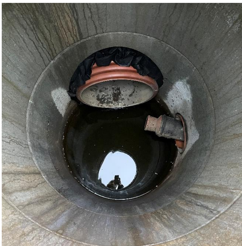
Figur 7 Utløpskum til nedlagt infiltrasjons- og fordrøyningsmagasin. Fra kummen går en utslippsledning OV200 til bekkelukkingen OV355 på høyre side (Kilde: bildet tatt på befaring).
