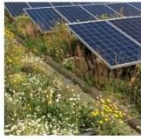
biosolartak (PV + sedumtak)
